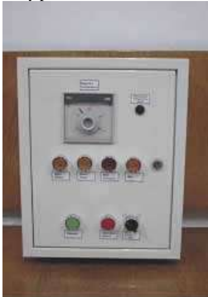
Rys. 20. Szafa sterownicza palnika gazowego [http://www.palnikigazowe.pl/szczegoly.html]
